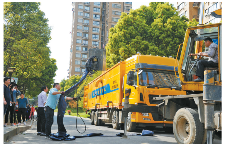
近日,鄞州区综合行政执法局引进了两辆移动污水处理车,在不良水体治理方面能够快速实现大流量的水体处理。图为污水处理车在鄞州世纪花园附近的河道上进行水体净化作业。(胡龙召 包静琴 摄)
