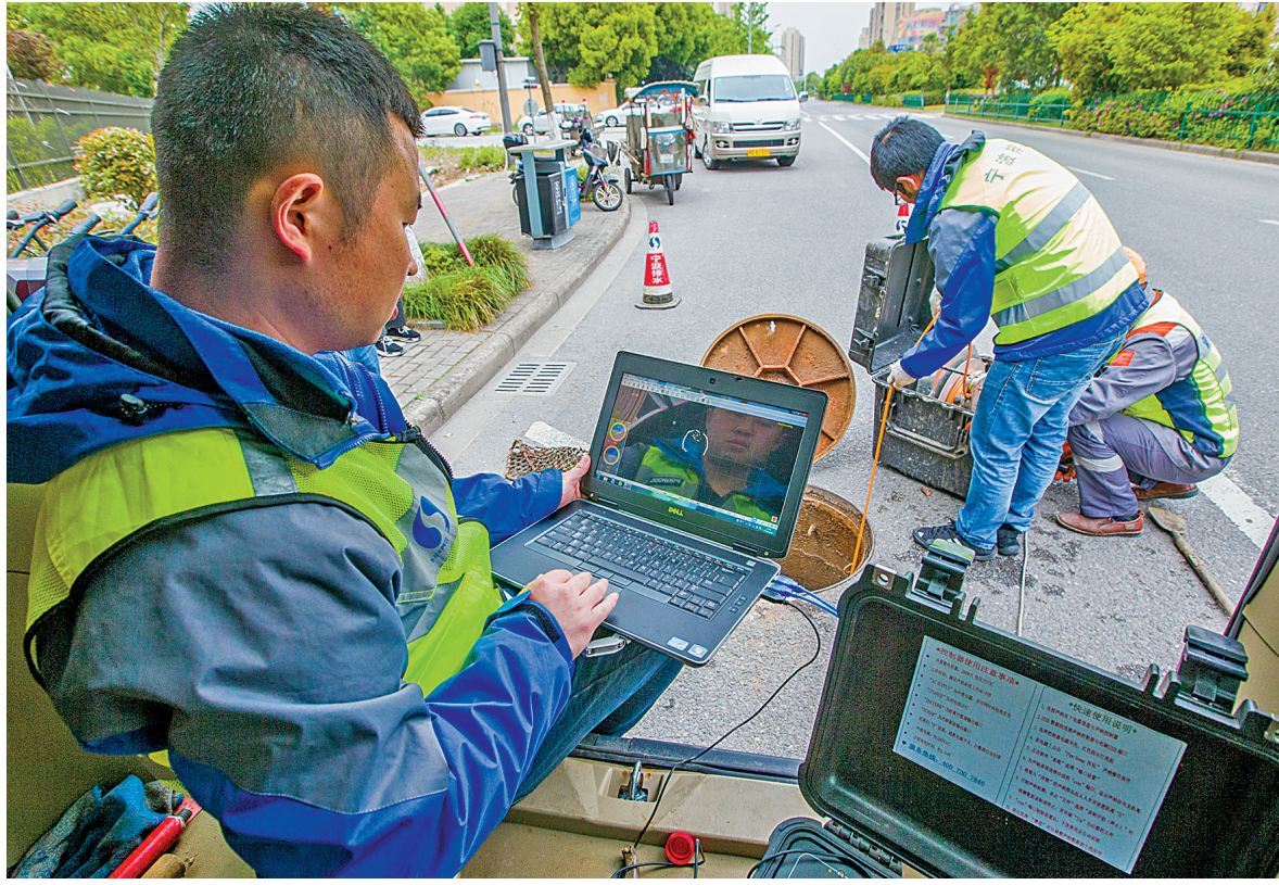
昨天上午,市排水公司管网运营分公司正在气象路运用管道检测“新装备”对污水管道进行全面“体检”。(刘波 摄)
