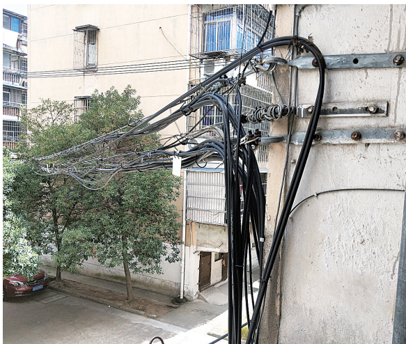
乱拉乱接的电线电缆。
