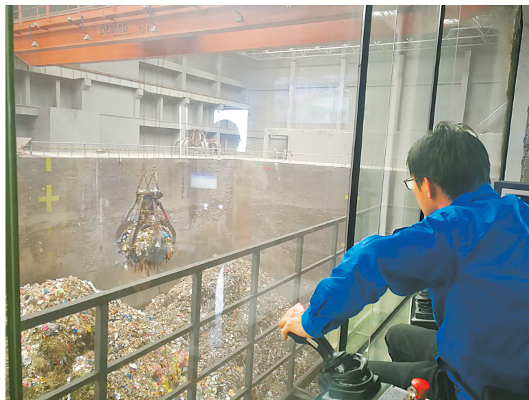
垃圾吊控制室内作业情况。
