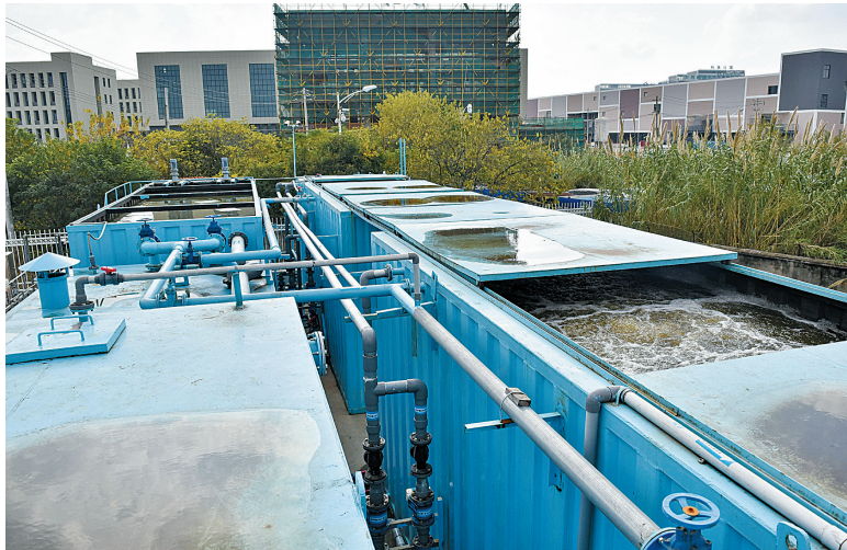
图为污水处理设施。
