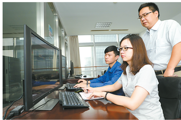
配电自动化主站人员检查后台运行情况(右一为张黎明)。 (通讯员供图)
