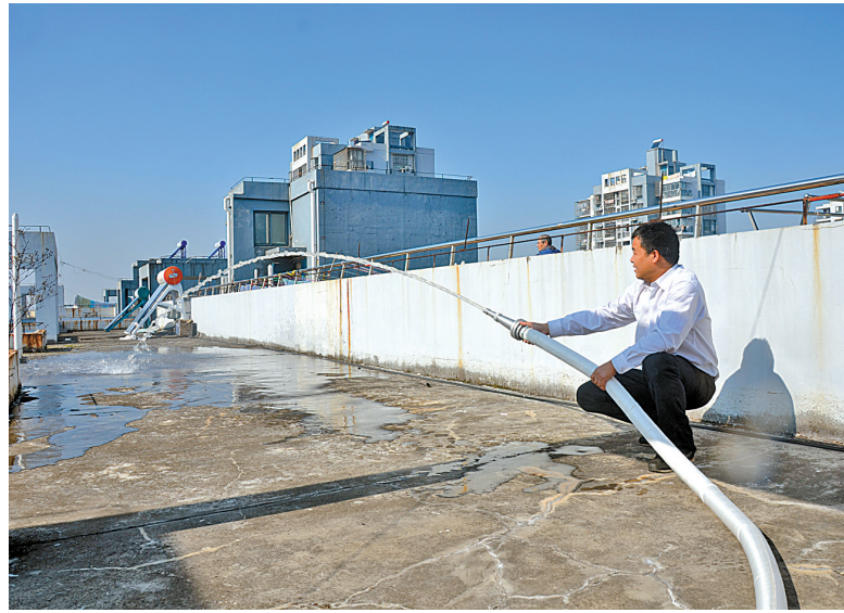
汇嘉新园南区29幢，居民楼的消防用水很充足。（廖业强 摄）
