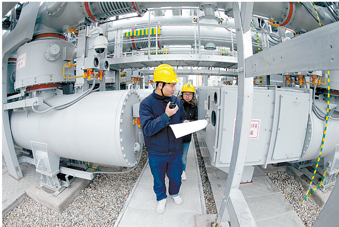
正式投运之前,电力工人对设备进行详细检测。
