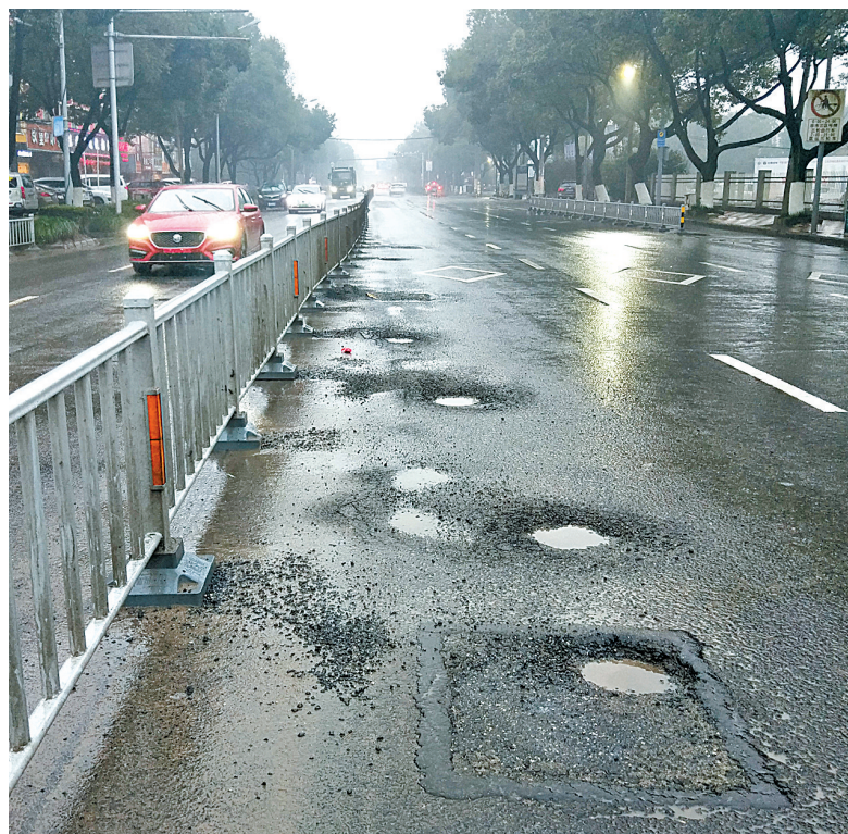
布满坑洞的机动车道。
