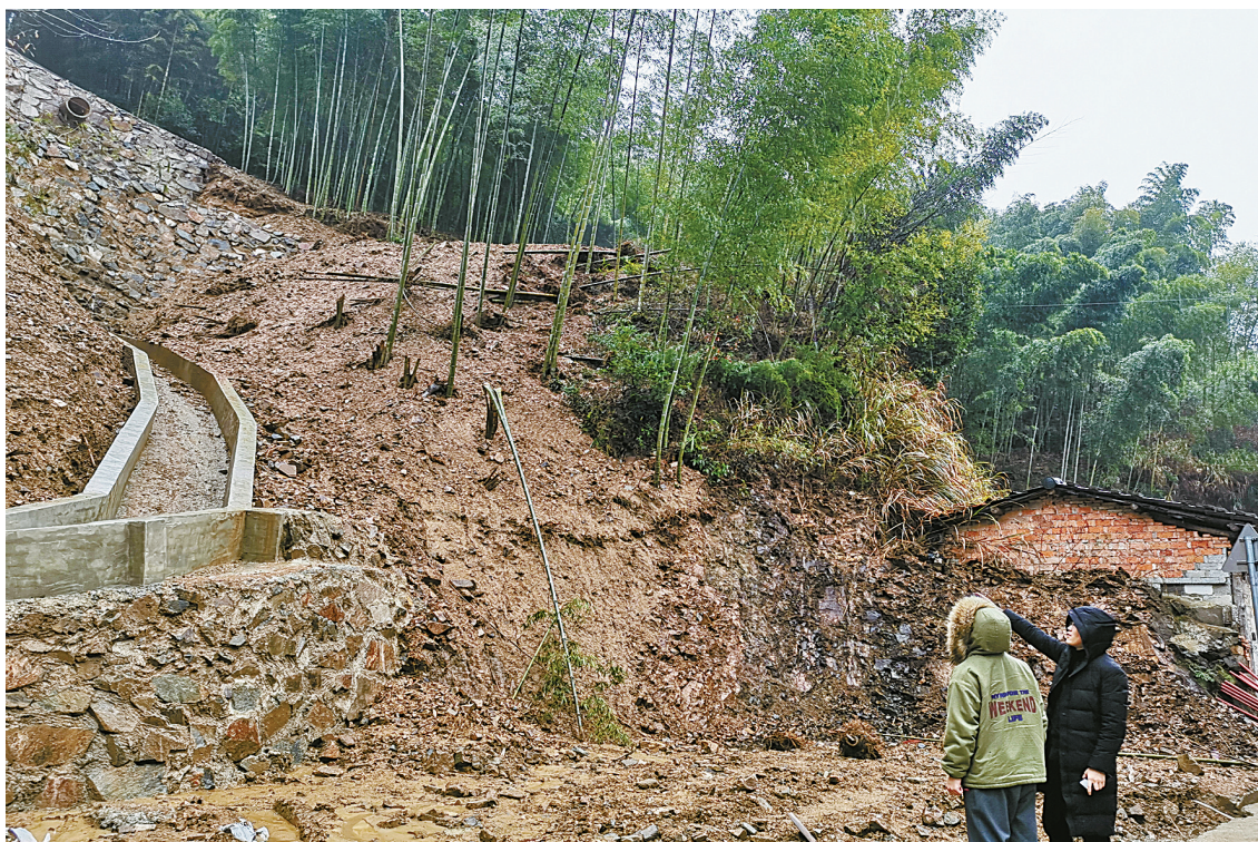
山体崩塌现场。
