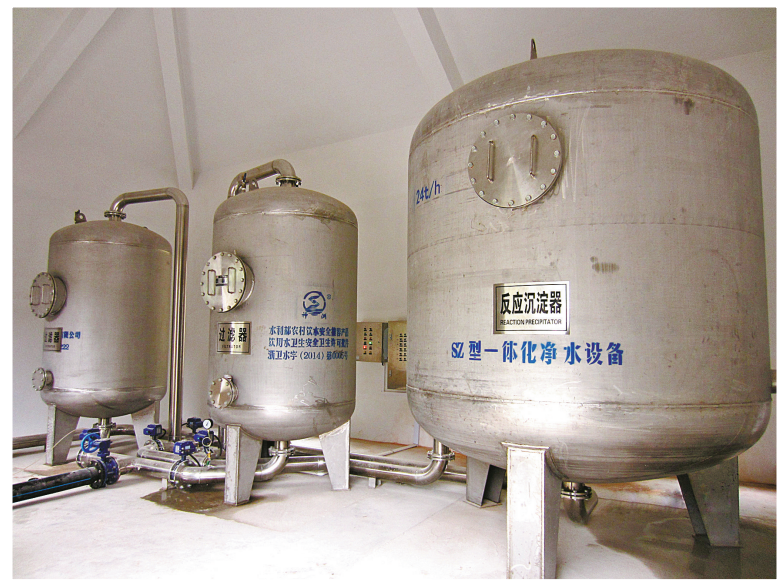
象山隔溪张供水站一体化净水设备
