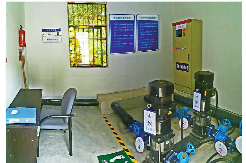
奉化印家坑水站的泵房
