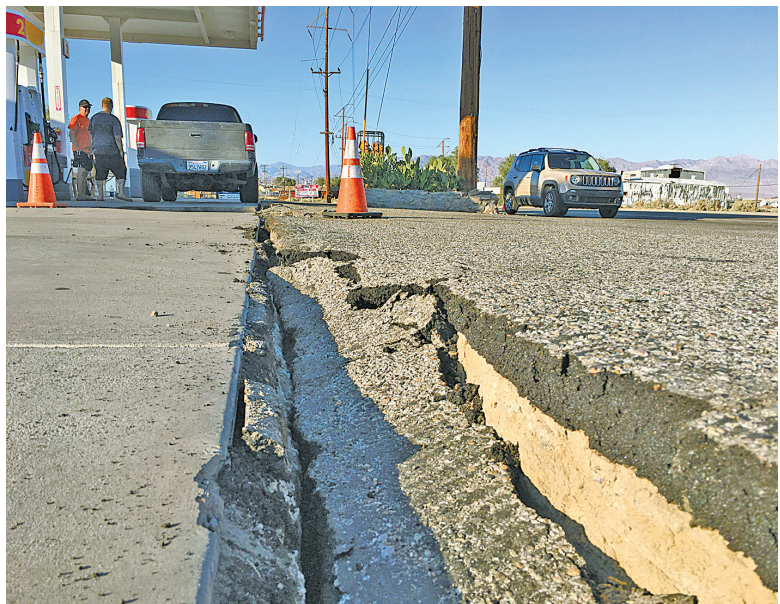
7月6日，在美国加利福尼亚州小镇特罗纳，道路在地震中受损（手机照片）。（新华社记者 檀易晓 摄）
