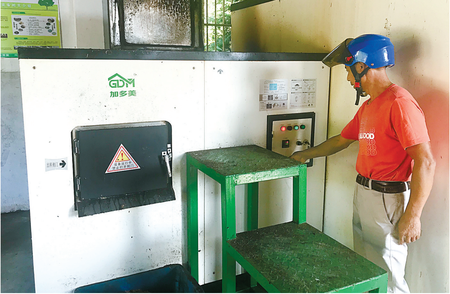
厨余垃圾处理站。（孙吉晶 蒋攀 摄）
