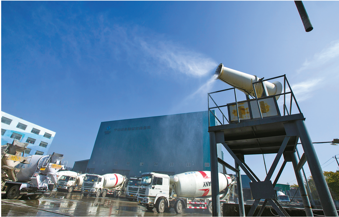
宁波今新集团有限公司进出场喷淋系统正在进行喷雾降尘作业。
