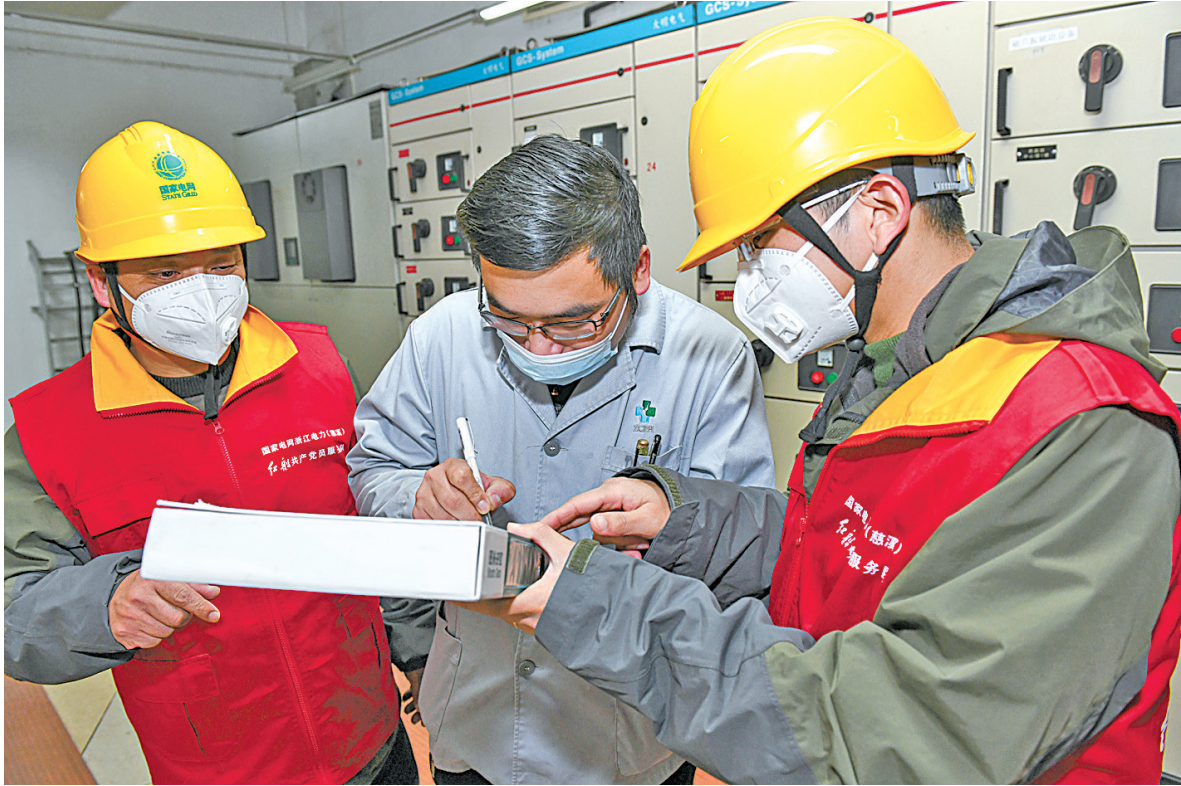
电力工人在医院配电房保电巡查。
