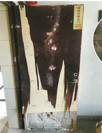
▲青林湾东区多幢楼内的“消火栓月度检查表”仅勾了2019年10月、11月。 ▲防火门门板破损,无法关闭,门板内的泡沫外漏。(傅仲楠 摄)
