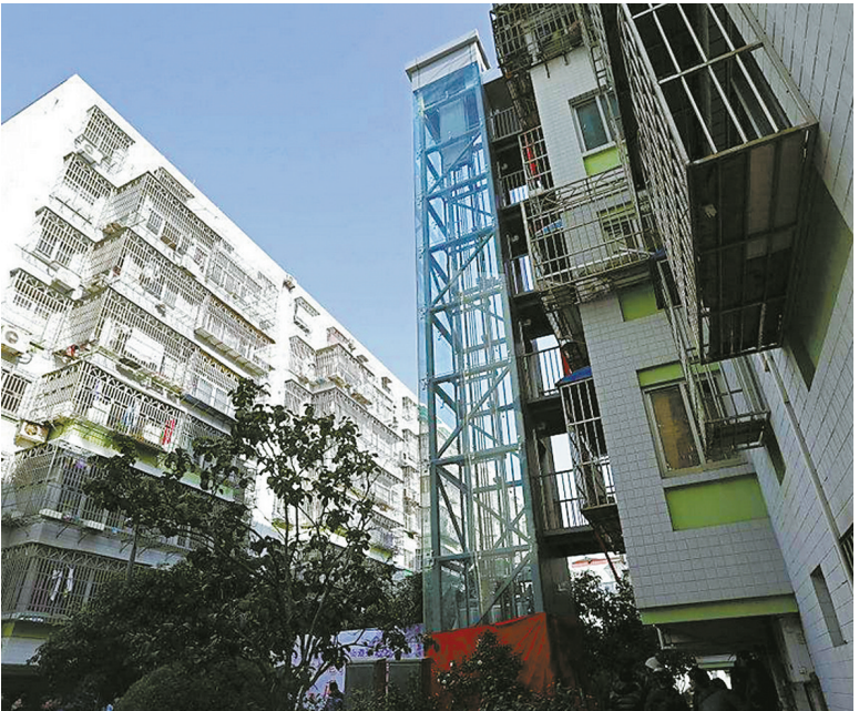
鄞州孔雀小区内加装的电梯(资料图片)。(市住建局提供)
