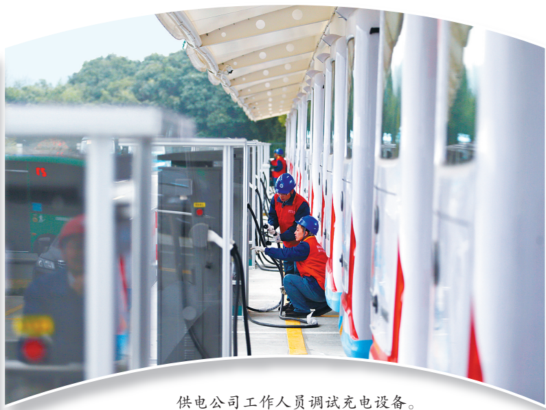
供电公司工作人员调试充电设备。
