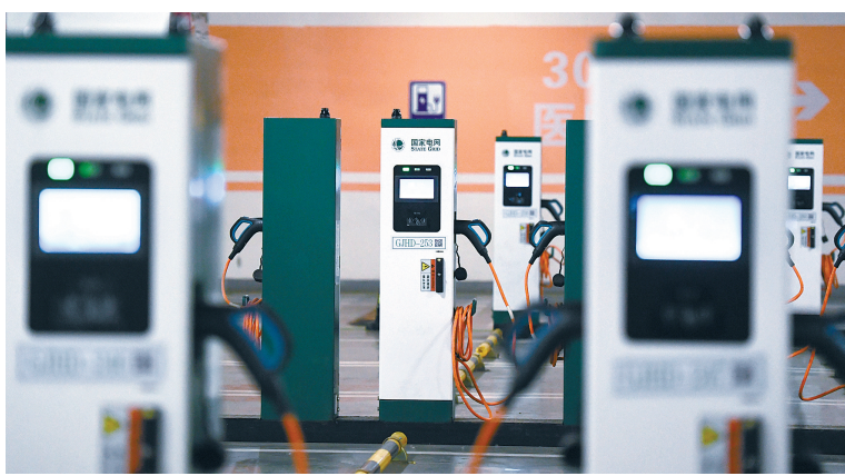
5月16日拍摄的位于五棵松体育中心地下停车场的电动汽车充电站。北京规模最大的集中式电动汽车充电站已于5月15日在五棵松体育中心地下停车场投入使用。该充电站共有200个充电桩，单日可最大提供1300车次充电服务能力。（新华社发）
