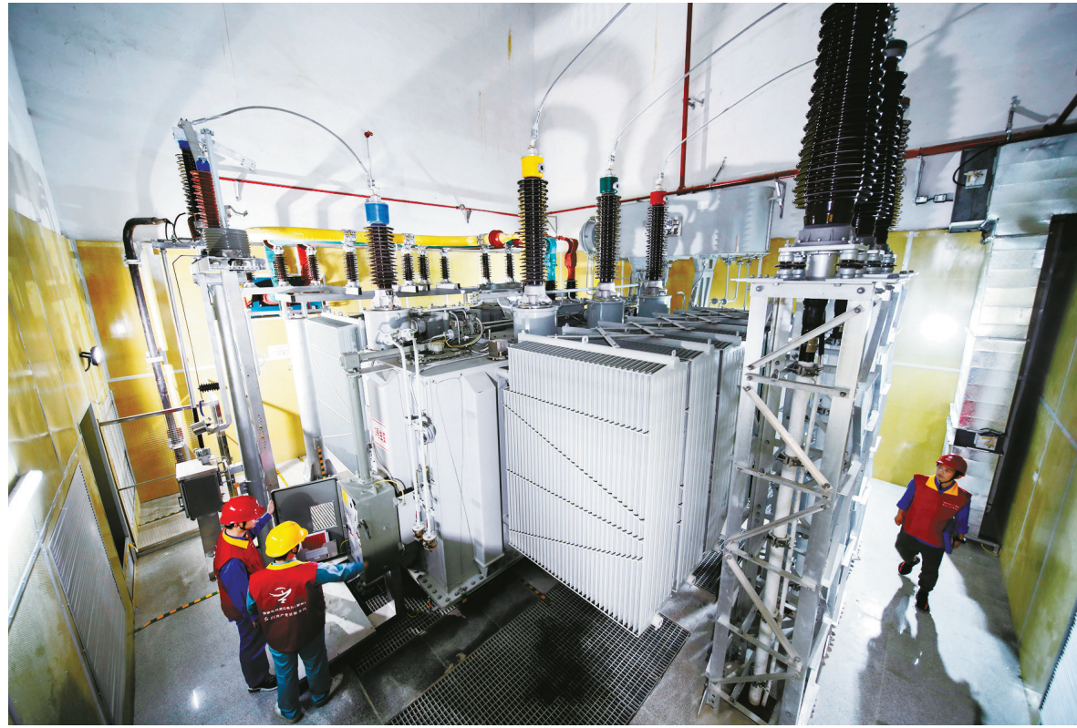
地下变电站的主变压器放置区域。
