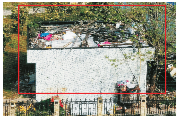
小屋屋顶上垃圾堆积。(网友截图)
