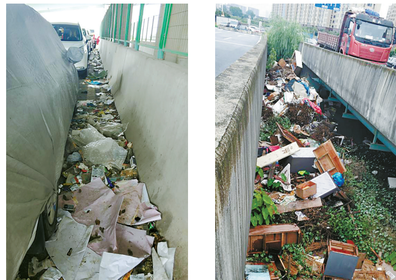
桥上桥下堆满垃圾。(邱韵 摄)
