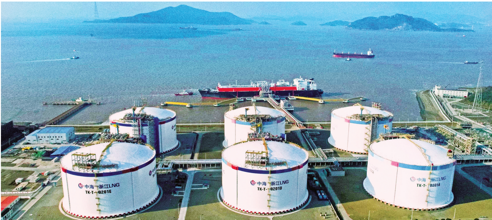
顺利投用的浙江LNG二期工程项目。
