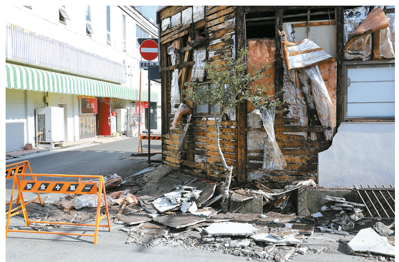
这是2月14日在日本福岛县相马市拍摄的一处因地震导致外墙脱落的房屋。（新华社发）
