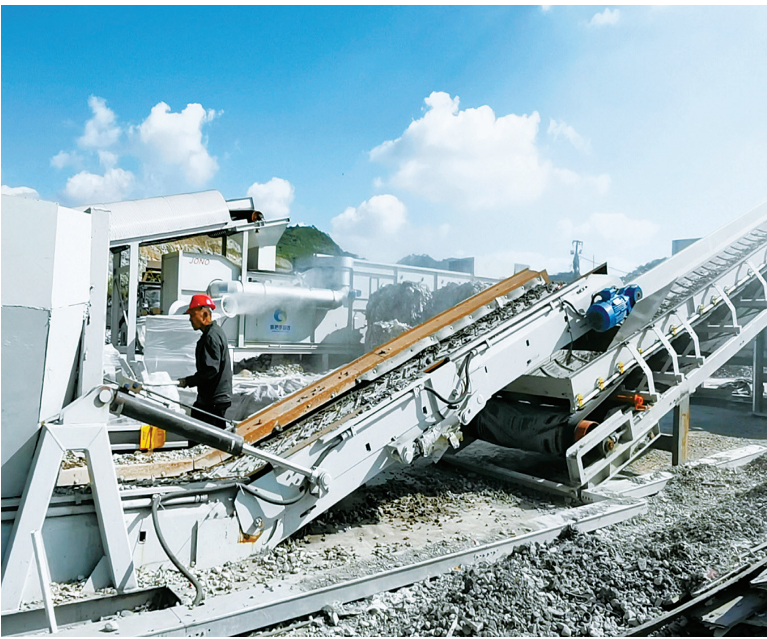
位于高新区的装修垃圾堆体处置设备。（张凯凯 江一舟 摄）
