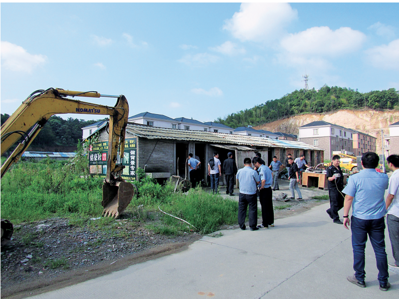
图为执法人员组织拆除违章建筑。
