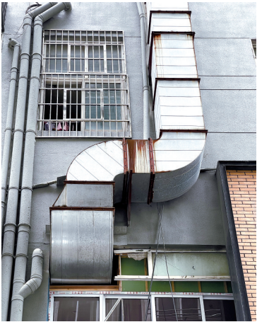
窗口位置接出的排管道直通楼顶。（仇龙杰 摄）
