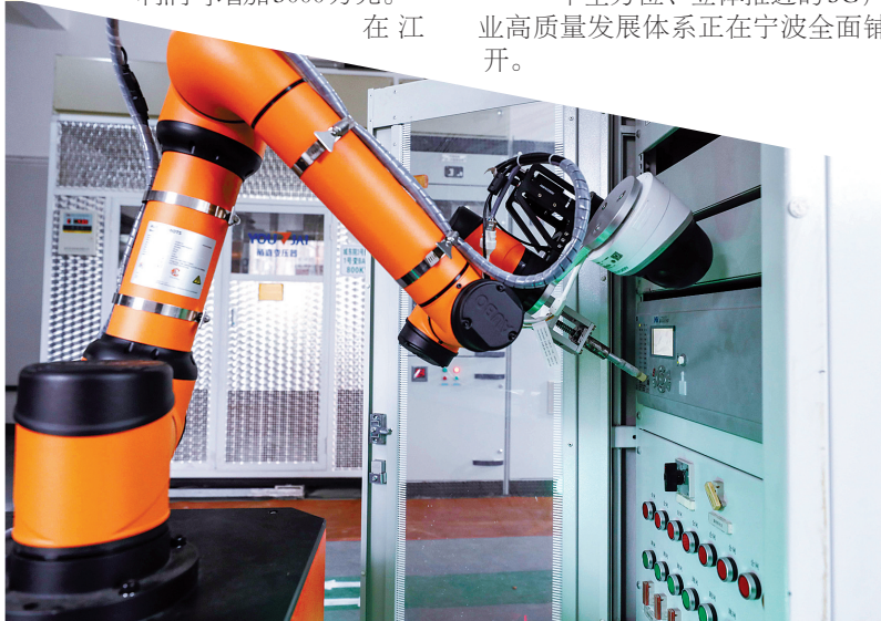
借助5G技术,甬产“哪吒”机器人在配电房设备出现故障时,可第一时间进行检修。(殷聪 摄)
