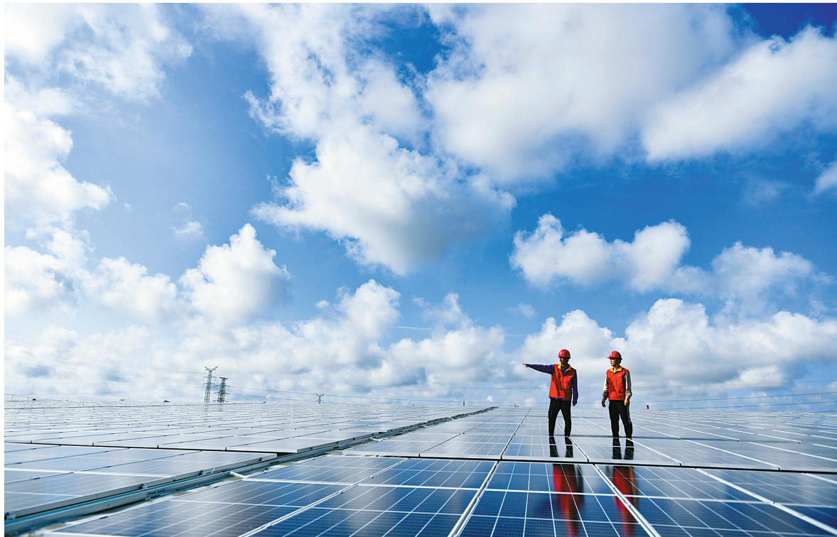
浙江鸿志远金属制品公司“1.6兆瓦光伏+1兆瓦时储能”光储一体化项目。(戚佳东 摄)
