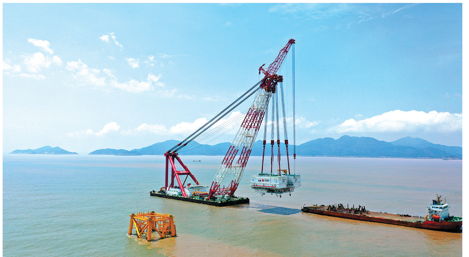
位于象山鹤浦的国电象山1号海上风电场一期工程建设现场。
