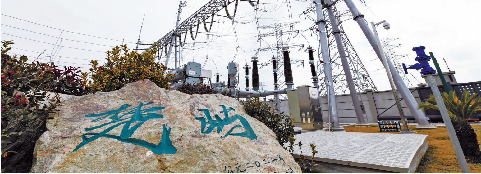
昨天，220千伏楚鸣变电站在中意宁波生态园正式送电投运，成为2022年我市投运的首座220千伏变电站。楚鸣变投运后，将进一步优化余姚经济开发区滨海新城区域电网网架结构，提高供电安全可靠。 （吕洪波 徐能 摄）
