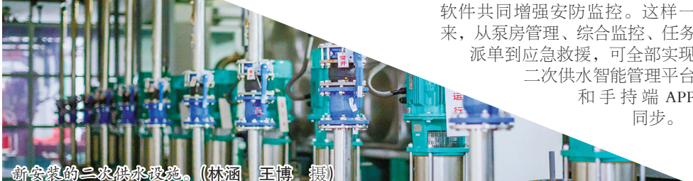
新安装的二次供水设施。(林涵 王博 摄)
