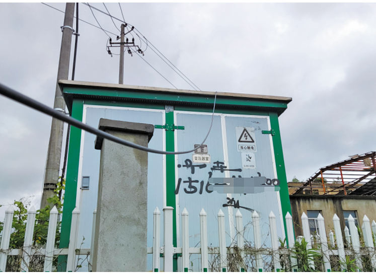
一条线缆从变压器室顶部接出后通往一厂房。
