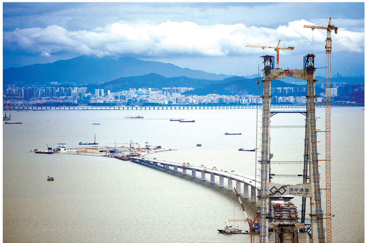
深中通道伶仃洋大桥东塔、西人工岛及远处的深圳市区(2022年6月7日摄)。(新华社记者 邓华 摄)
