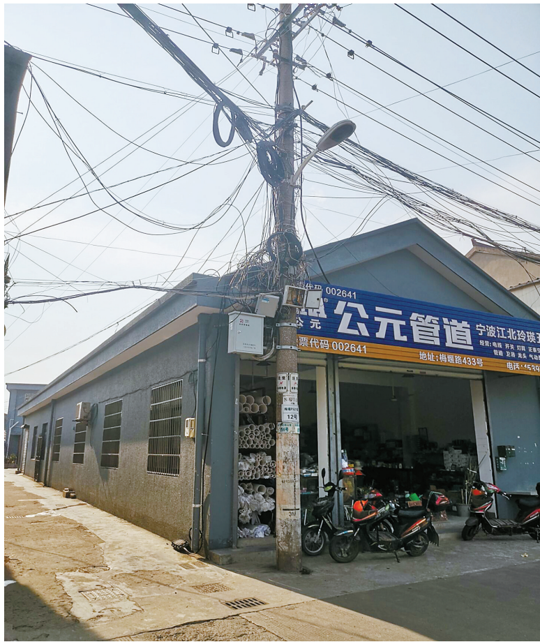
江北区河东村内电线杆上缠着密密麻麻的电线。（石景 摄）
