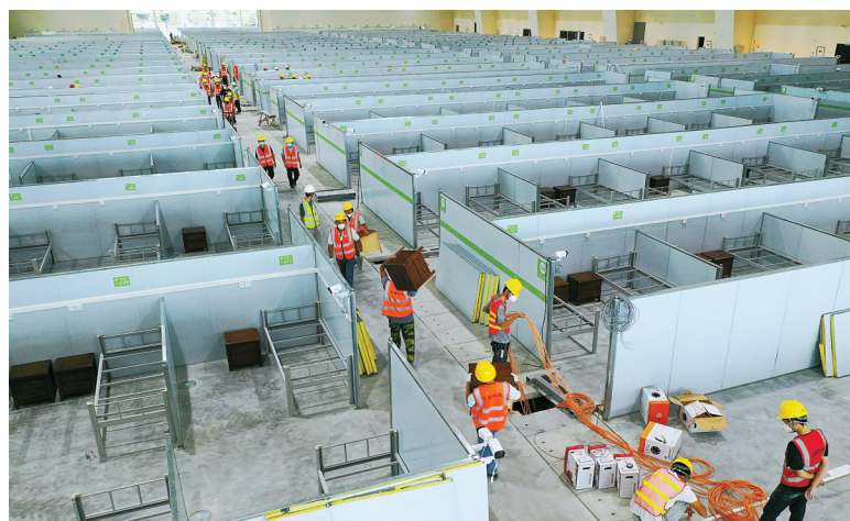
8月10日，工人在三亚第二方舱医院作业(无人机照片)。为应对本轮疫情，海南省三亚市将保利C+国际博览中心改建为第二方舱医院。第二方舱医院总建筑面积2.12万平方米，可容纳床位2000张，将于8月11日完工交付。(新华社记者 郭程 摄)
