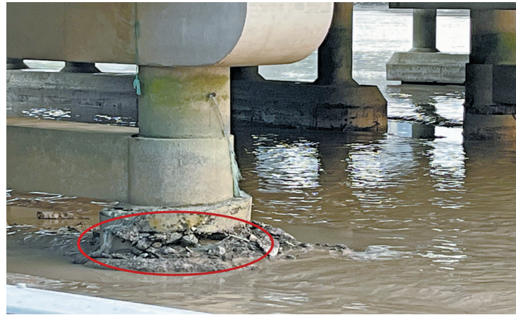
解放桥桥墩底部混凝土出现缺失。（网友供图）
