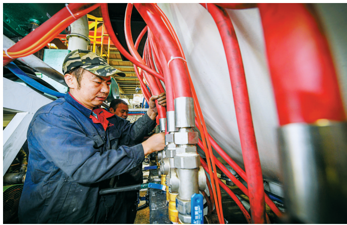
宁波伏尔肯科技股份有限公司安装新的真空烧结炉，以烧结更大尺寸的3D打印产品。(严龙 曲晓辉 摄)
