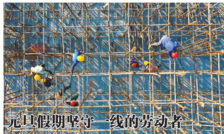
12月31日，在江西省吉安市永丰县生物医药产业园，建筑工人在工地忙碌（无人机照片）。元旦假期期间，江西省吉安市永丰县重点项目建设者坚守岗位，抢工期保进度。（新华社发）
