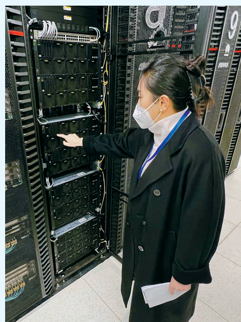
工作人员介绍机房内部构造。(殷聪 摄)
