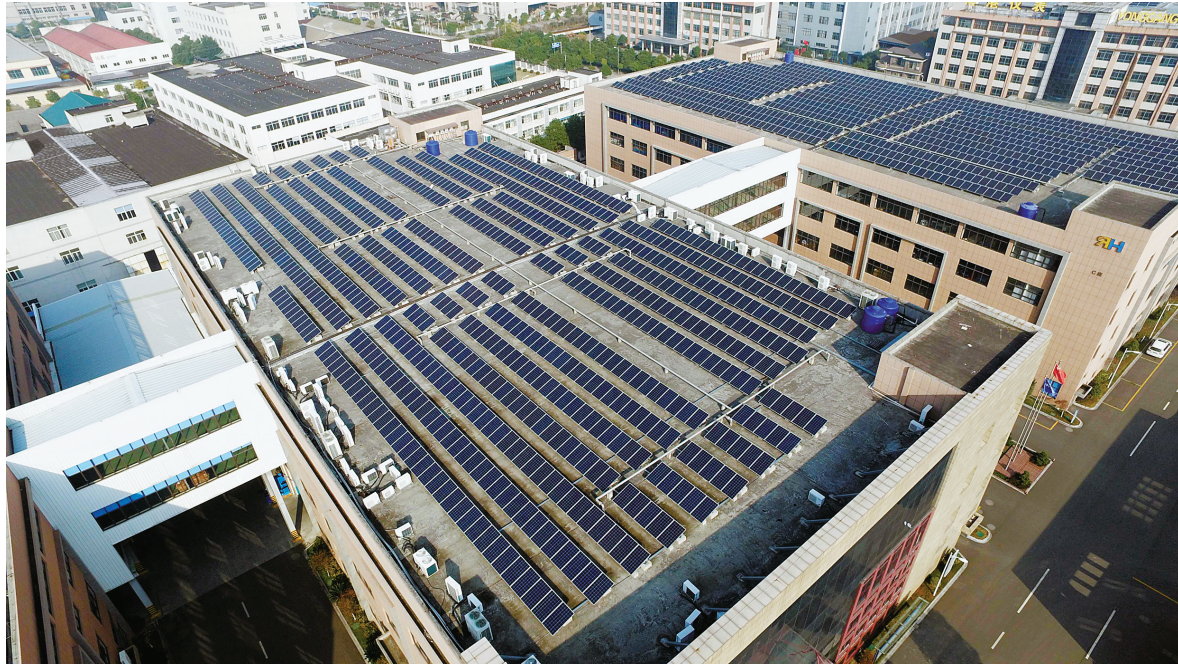
图为浙江人和光伏有限公司厂房屋顶上的连片太阳能光伏板。
