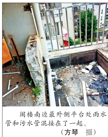
阁楼南边最外侧平台处雨水管和污水管混接在了一起。(方琴 摄)
