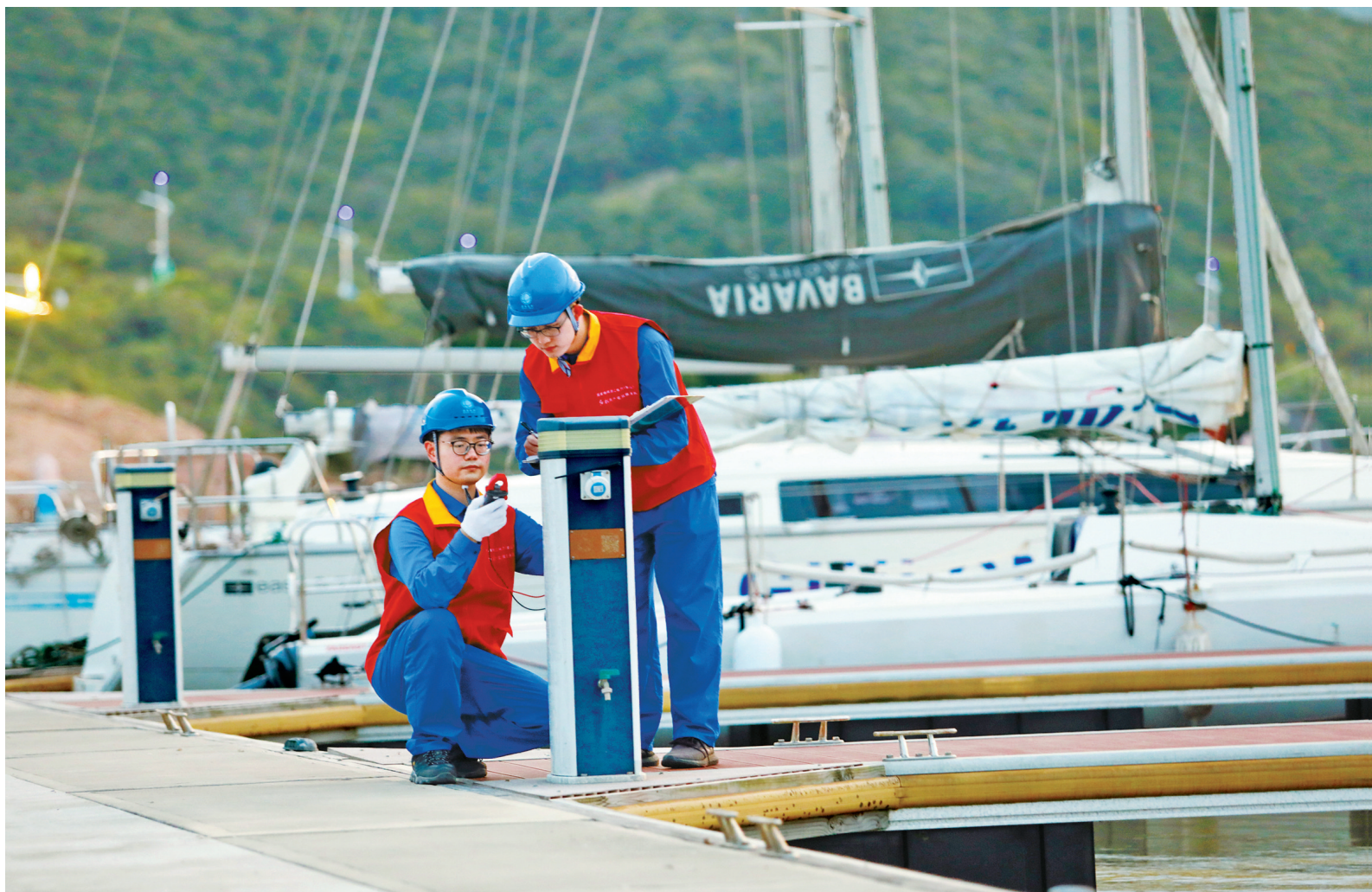
连日来，国网宁波供电公司对象山亚帆中心、沙排中心两处亚运场馆供电设施开展“数字化+”全面体检，确保场馆供电线路设备保持健康状态。(王鹏 王幕宾 摄)
