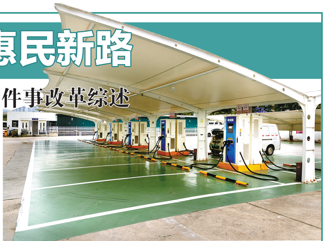
宁海金水路新能源充电站场景照。
