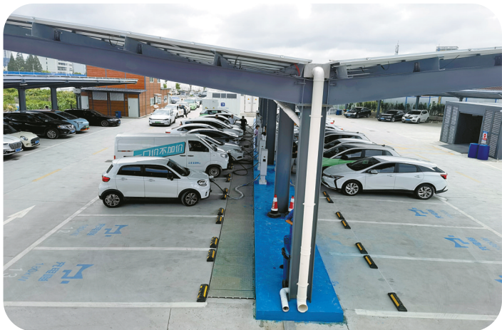
新能源光储充电站位于大通桥站C口。
