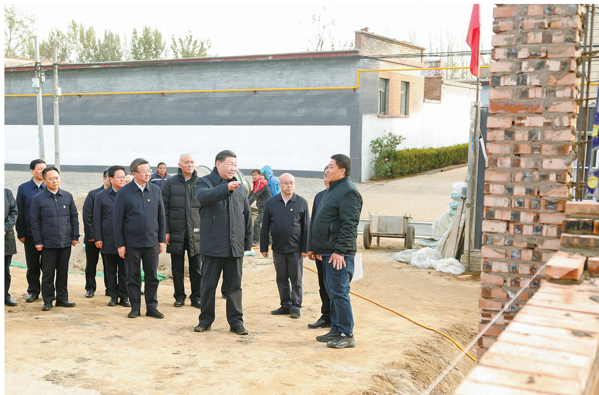
10日下午，习近平在河北保定涿州市刁窝镇万全庄村房屋重建施工现场考察。
