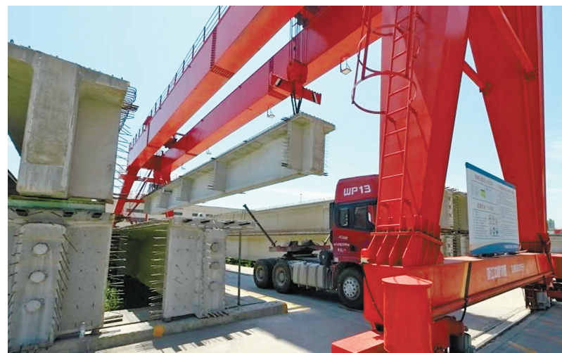
30米T梁在工厂中制造出来后，被安装在所需位置。(金鹭 甘军仁 摄)
