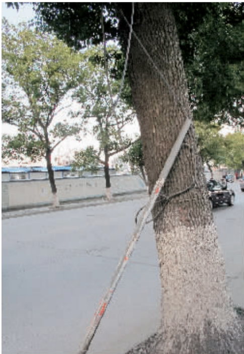
鄞奉路上下垂和拖地的电线。
