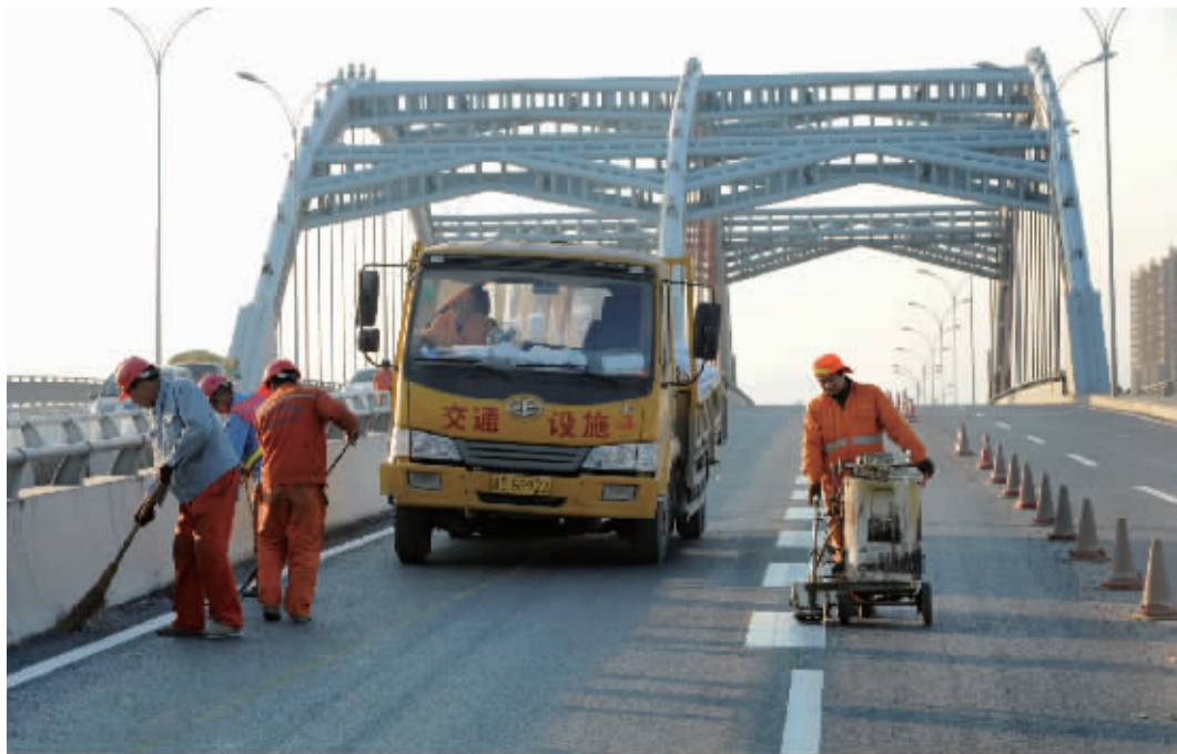
鄞州大桥今天清晨5点起正式恢复双向通车。图为昨天下午施工人员在桥面上划标线。
