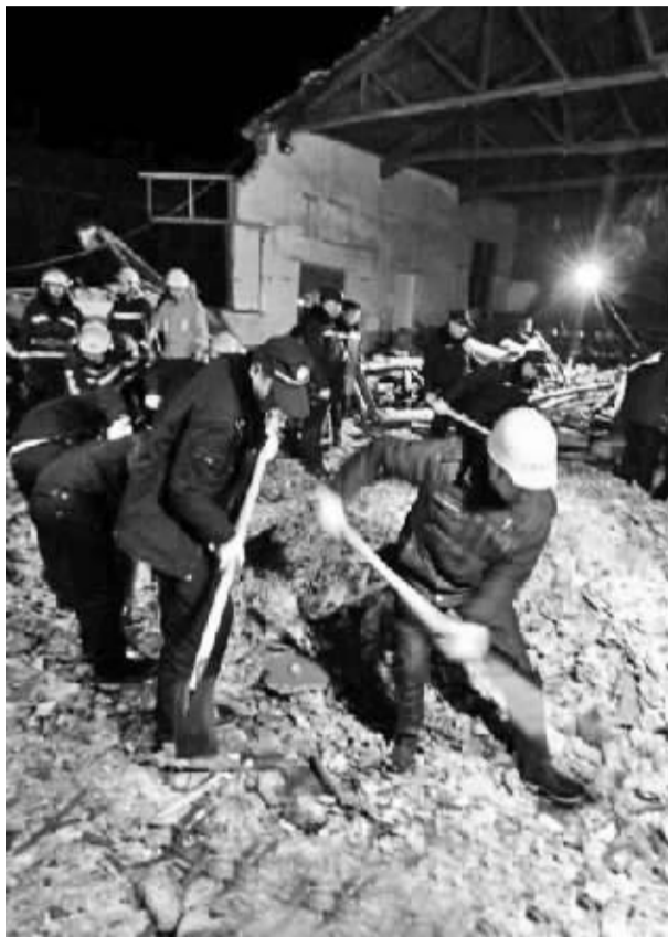
13日晚，磐安县公安消防人员在事故现场搜救。 据浙江在线
