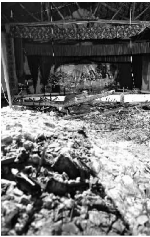
坍塌事故现场。新华社发
