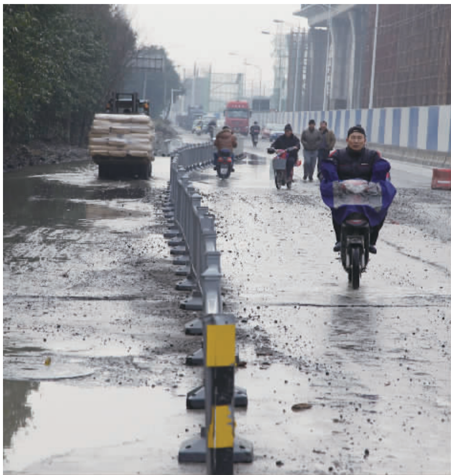
积水严重、坑坑洼洼的这段路。
